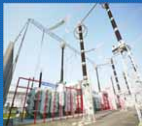
特变电工输变电产业
