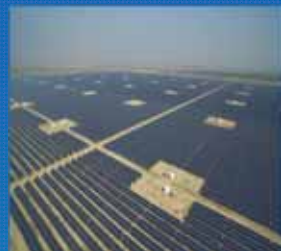
特变电工新能源产业
